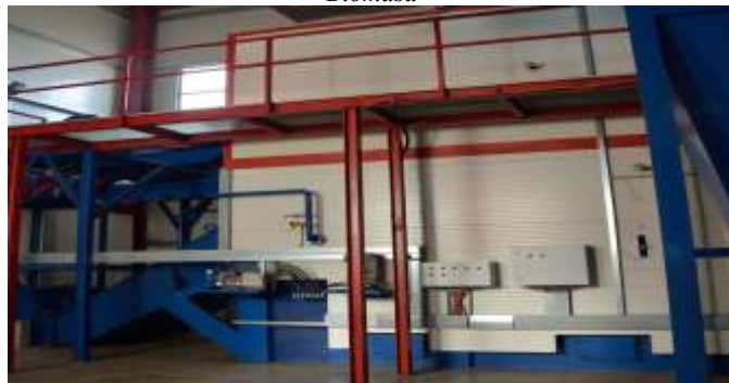
Centrală biomasă (căldură + energie electrică)
