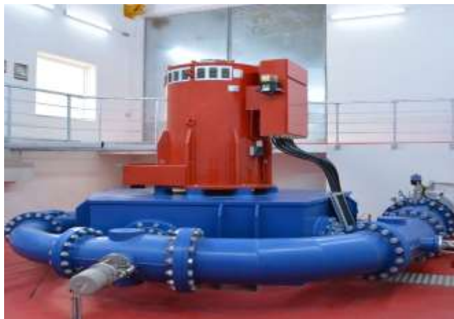
Uzina electrică – Hidrocentrala Șanț
